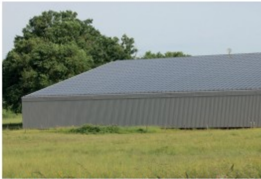
Unité de teintes et continuité entre les panneaux photovoltaïques et le bardage métallique gris
